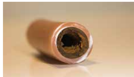
Versprödetes und verschlammtes Bodenheizungsrohr.
