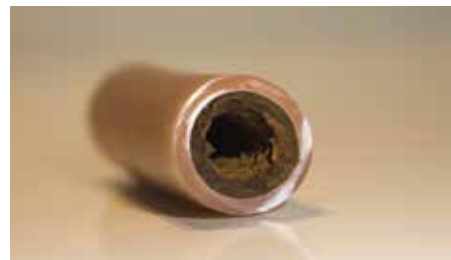
Versprödetes und verschlammtes Bodenheizungsrohr.
