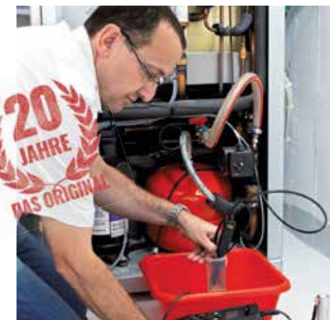
Das HAT-System ist seit 1999 im Einsatz.
