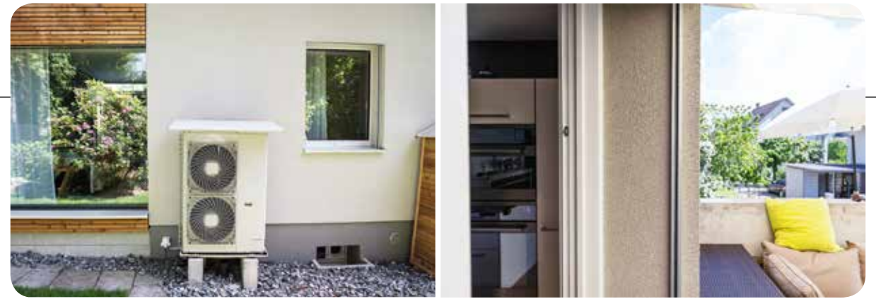
Eine umweltfreundliche Luft-Wasser-Wärmepumpe ersetzte die Gasheizung. Sie ist dank der guten Dämmung der Gebäudehülle sehr kostengünstig im Betrieb.
