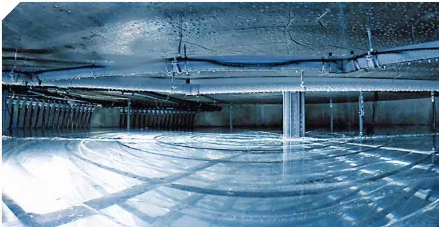
Ein Eisspeicher verbessert die Energieeffizienz einer Wärmepumpe deutlich.
