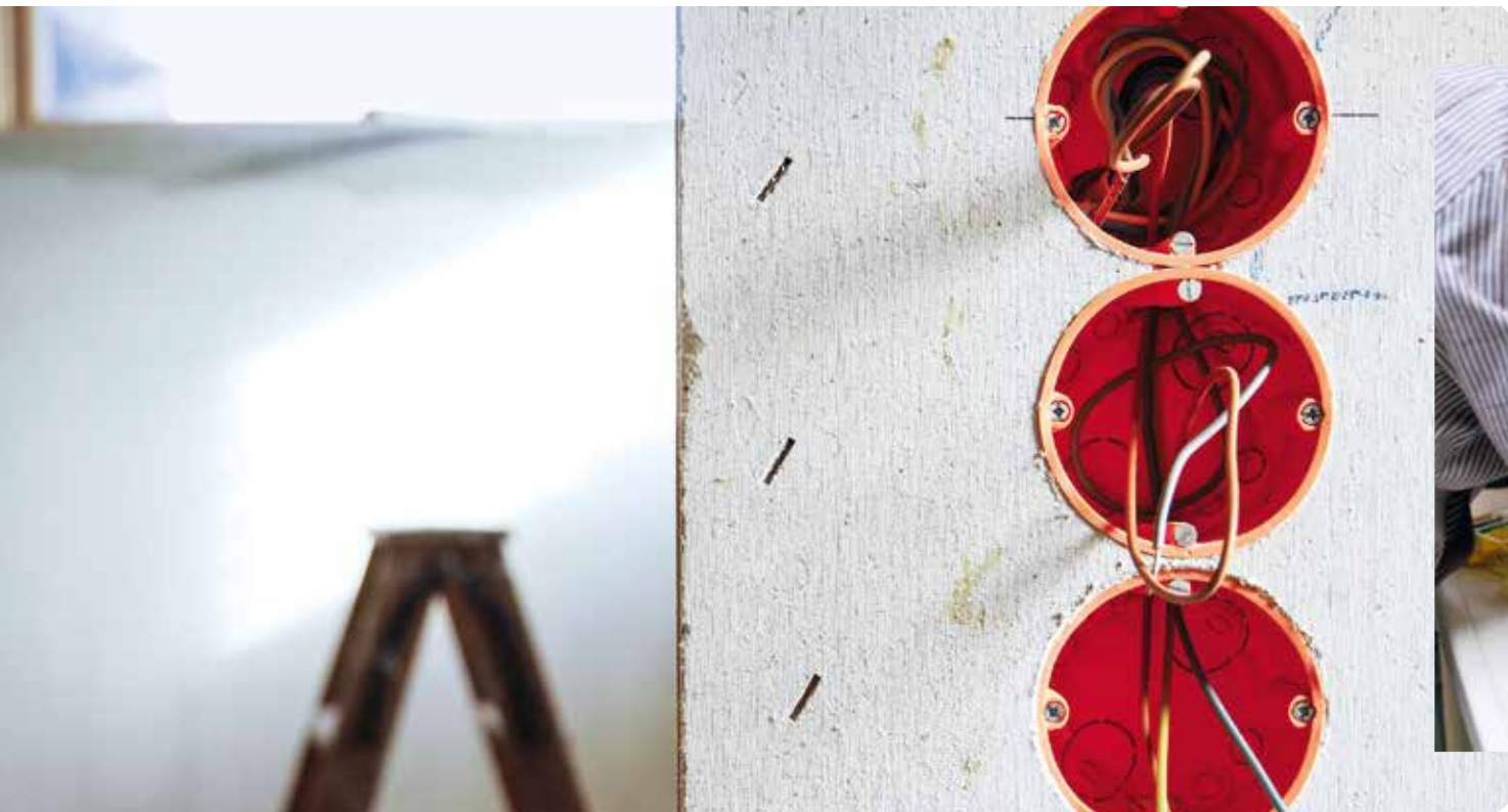
Ob neue Stromleitungen oder ein kaputter Wasserhahn: von Zeit zu Zeit muss eine Fachperson ans Werk.
