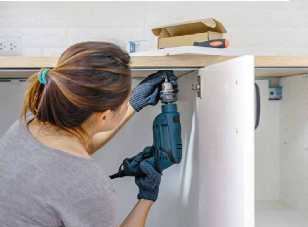
Bei vielen Arbeiten können Heimwerker ihrer Kreativität vollen Lauf lassen. Bei Elektrizität ist hingegen Vorsicht geboten.
