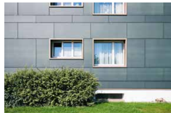
Auch bei diesem Haus im zürcherischen Opfikon produzieren Dünnschichtzellen an der Fassade auf diskrete Weise Strom.
