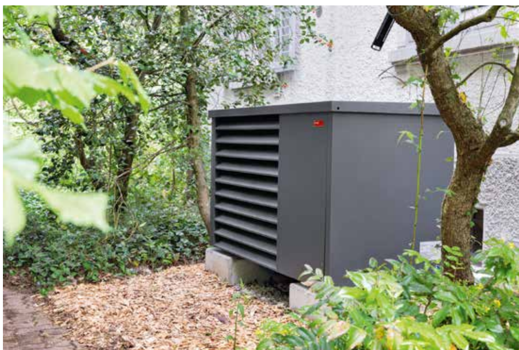
Die neue, energieeffiziente Anlage ist eine Kombination aus Wärmepumpe und Gas-Brennwertkessel.
